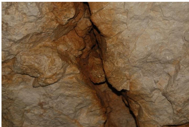
Szczeliny w stropie
